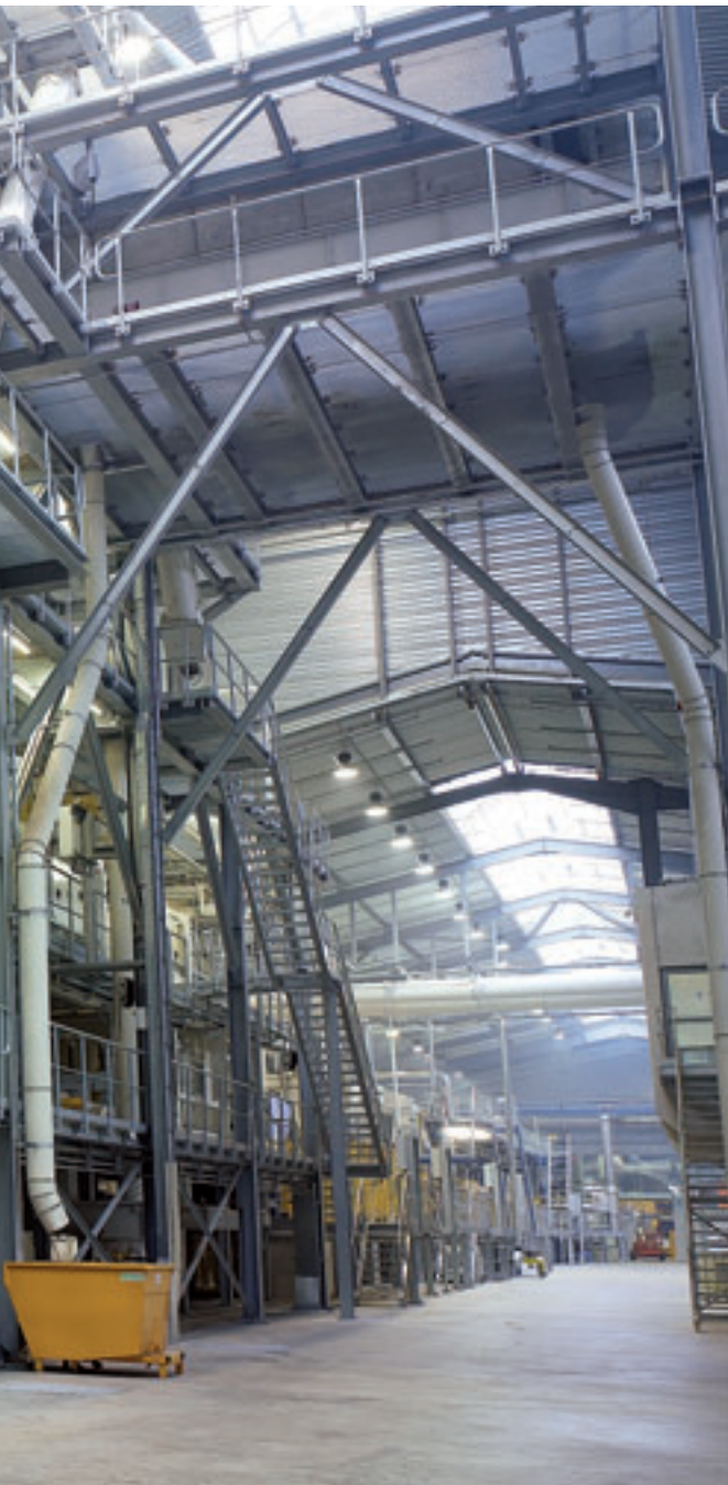
Form- und Pressenstraße von Siempelkamp
