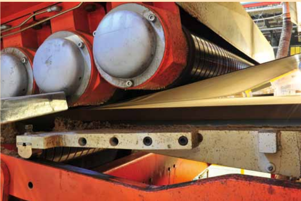
Einfahrwellen im Presseneinlauf
