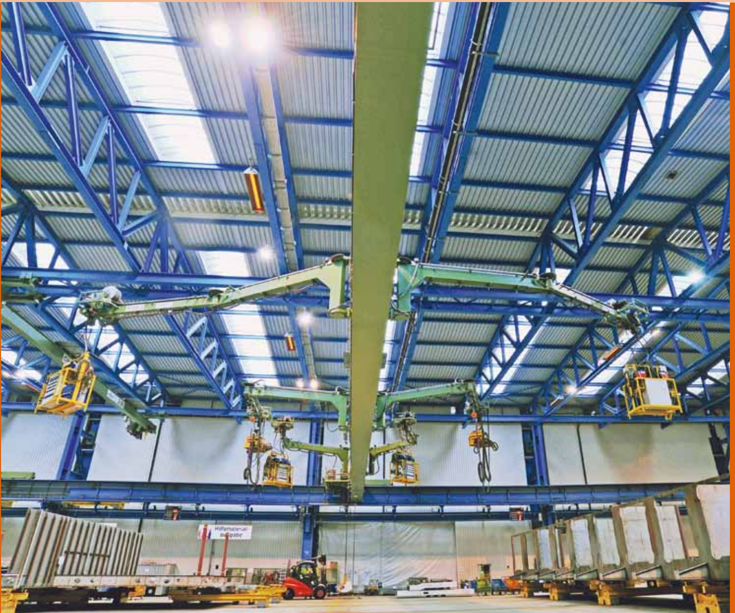
Einträgerbrückenkran ausgerüstet mit sechs Knickarmen und Tool-Boxen
