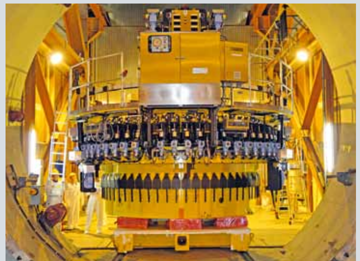
2011 im KKW Gravelines: Die neue optimierte Schraubenspannmaschine kommt zum Einsatz – Einbringen der Schraubenspannmaschine in das Containment
